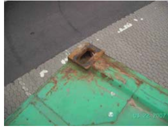
Hörn som släppt längst ifrån truck (Kortsidan utan dörr är den som släppt)
